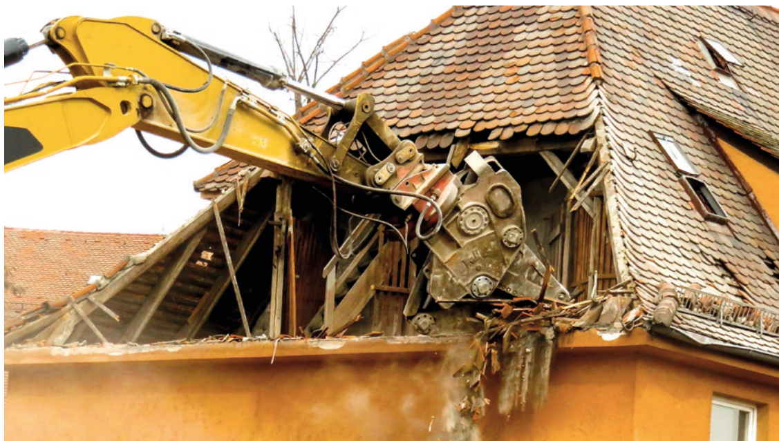
Mit der Förderung von „Assanierungen“ durch das Land Steiermark wird der Abriss von historischer Bausubstanz und der Neubau von Kleinwohnungen für Investoren noch lukrativer. FOTO: GERHARD G., PIXABAY
